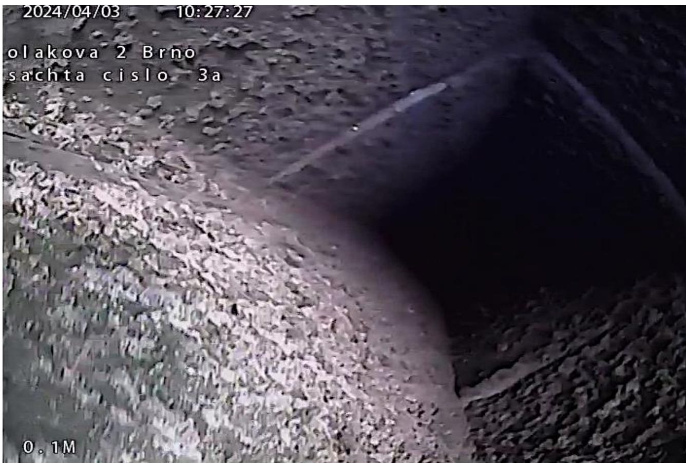
Extrémní znečištění, mastnota a plíseň v povlaku.
