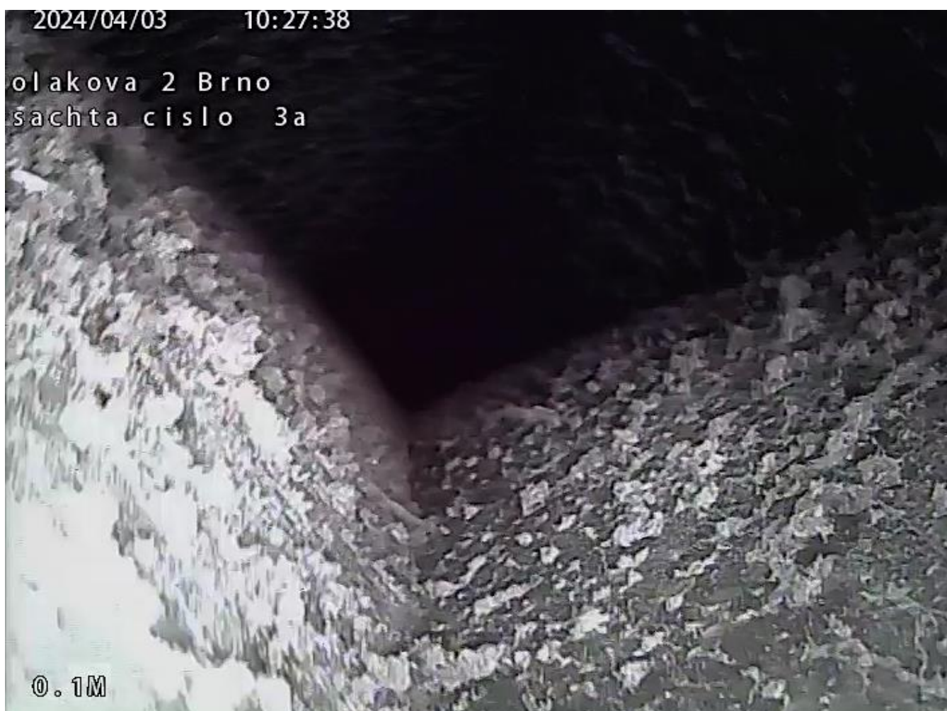
Extrémní znečištění stěn šachty.
