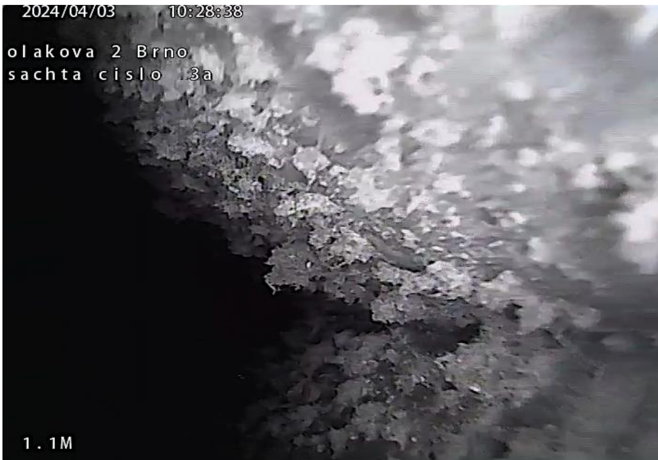
Hrubý nános nečistot na stěně šachty.
